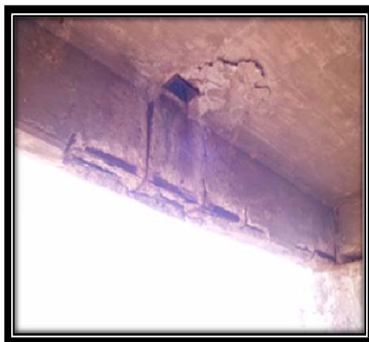
شکل ۹-۱: خرابی ناشی از خوردگی که به علت تجمع حلال یخ‌زدا در قسمت زهکش به وجود آمده است.
