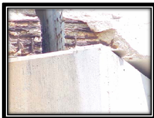
شکل ۹-۶: نمایی دیگر از خرابی تیر پل بر اثر خوردگی به دلیل ضعف پوشش بتنی.
