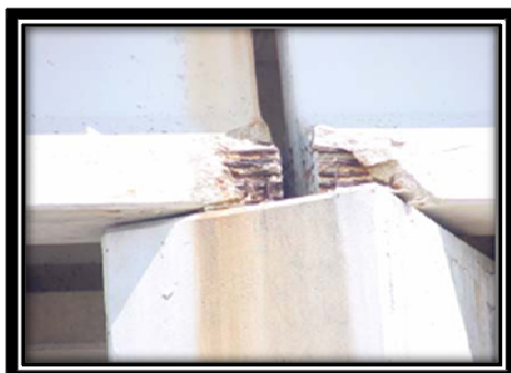
شکل ۹-۵: خوردگی حلال شیمیایی موجب خرابی تیر پل شده است که علت این پدیده ضعف درز و پوشش ضعیف بتنی انتهای پل بوده است.
