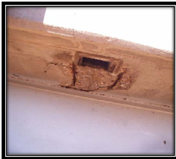
شکل ۹-۲: شکل دیگری از خرابی ناشی از خوردگی که به علت تجمع حلال یخ‌زدا در قسمت زهکش به وجود آمده است.
