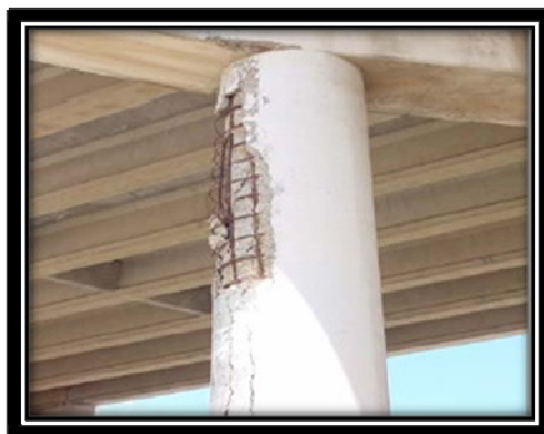
شکل ۹-۹: خرابی ستون ناشی از حلال شیمیایی.
