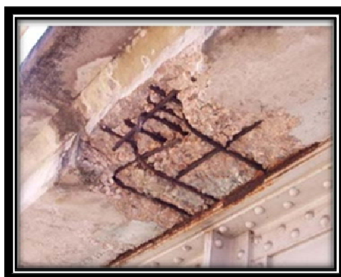
شکل ۹-۴: نگهداری ضعیف درز پل باعث شده حلال یخ‌زدا به لبه پل آسیب برساند. پوشش ثانویه فولاد و صفحه فولادی روی تیر نیز تخریب شده و صدمه دیده است.
