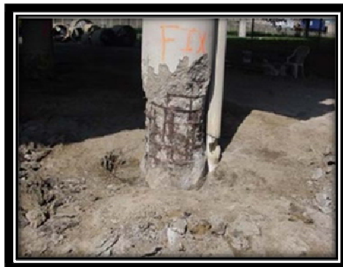
شکل ۹-۱۲: خرابی که بر اثر انبار نمک ایجاد شده است.
