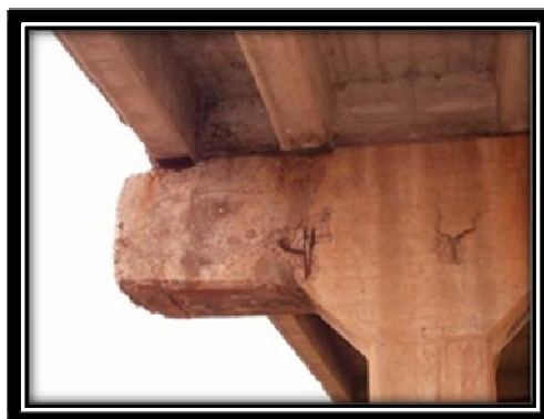
شکل ۹-۷: خوردگی باعث ایجاد خرابی در تیر طره پرتنش.
