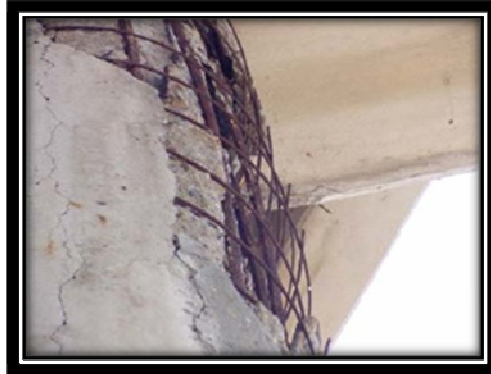
شکل ۹-۱۰: نمایی نزدیک از خرابی ستون نشان داده شده در شکل (۹-۹).
