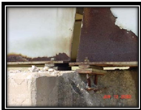
شکل ۹-۸: ریزش سرستون به علت خرابی ناشی از خوردگی پل.
