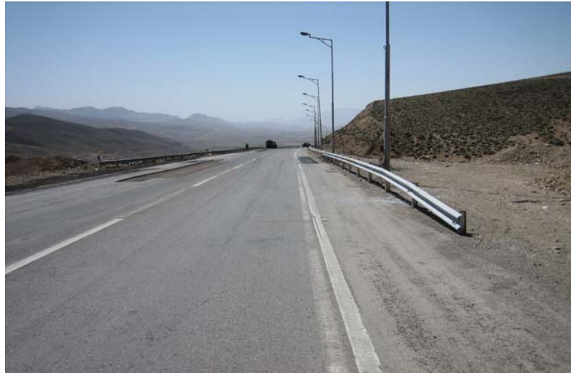
شکل ۷-۷۶: عدم استفاده از تابلوهای اطلاعاتی لازم در منطقه عملیاتی به خصوص در تاج قوس که محدودیت دید نیز وجود دارد.
