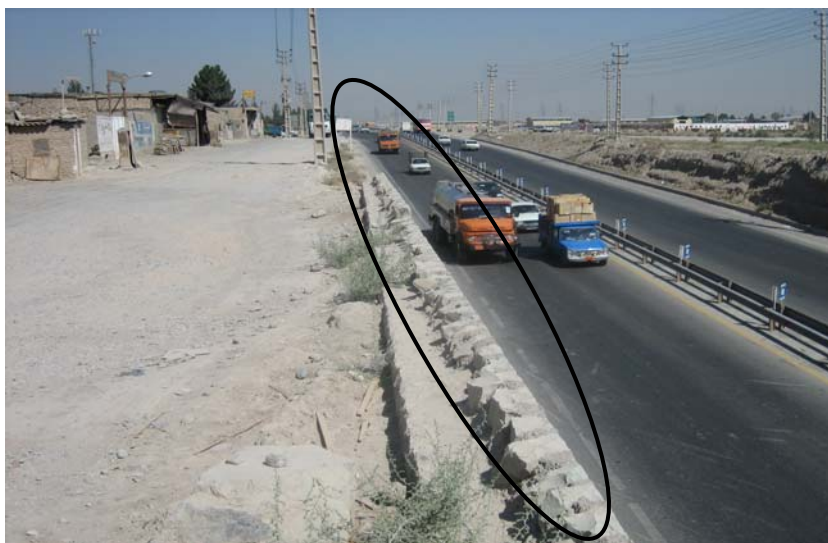
شکل ۷-۹۴: عدم وجود حفاظ در روی دیوار حایل برای جلوگیری از سقوط کاربران به داخل زیرگذر
