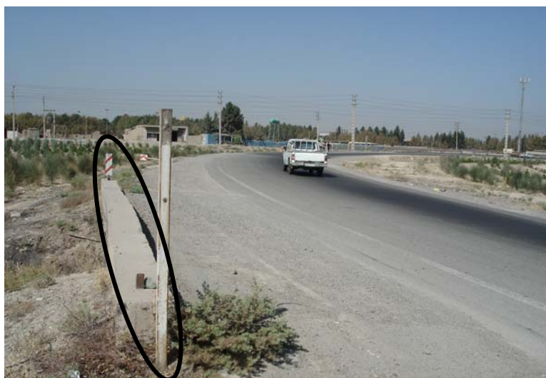
شکل ۷-۱۰۵: آبروی موجود در ورودی به راه اصلی از آزادراه که بدون محافظت رها شده است و خطر برخورد وسایل نقلیه منحرف شده وجود دارد.
