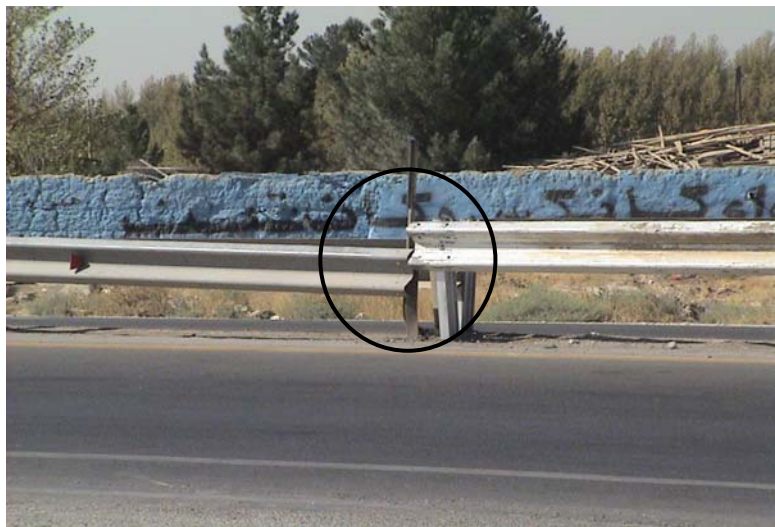
شکل ۷-۱۰۹: اتصال نامناسب گاردریلها و وجود گسیختگی بین آنها
