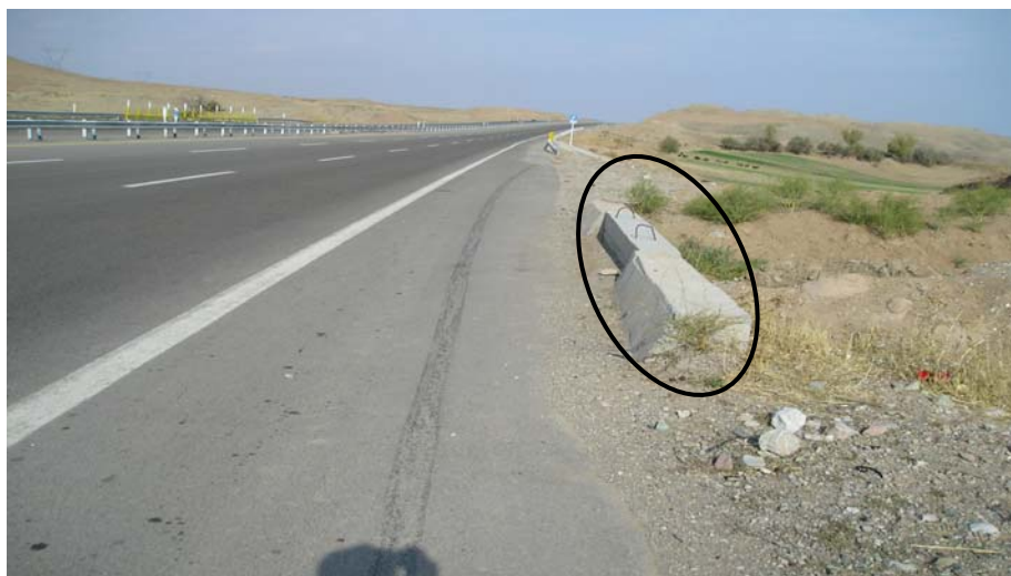
شکل ۶۷-۷: عدم وجود آشکارسازی بر روی جانپناه پل که به علت قابل دید نبودن آن در شب
