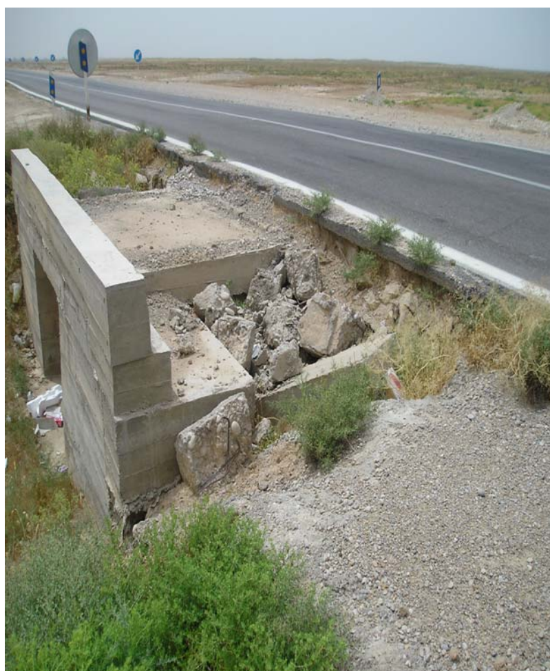
شکل ۲-۵: این یک راه اصلی در حال تعریض است. آبروی واقع در مسیر، تعریض شده و بدون آشکارسازی و هشدارهای لازم به رانندگان رها شده است. عدم رؤیت آن بویژه در شب، باعث ایجاد تصادف می شود.
