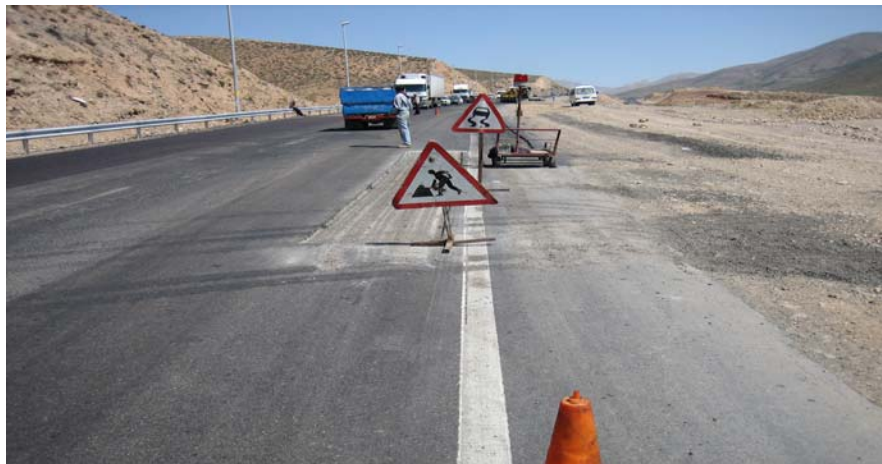
شکل ۷-۷۴: عدم استفاده از تابلوهای لازم در منطقه عملیاتی که باعث ایجاد خطر برای رانندگان و کارگران می‌شود.
