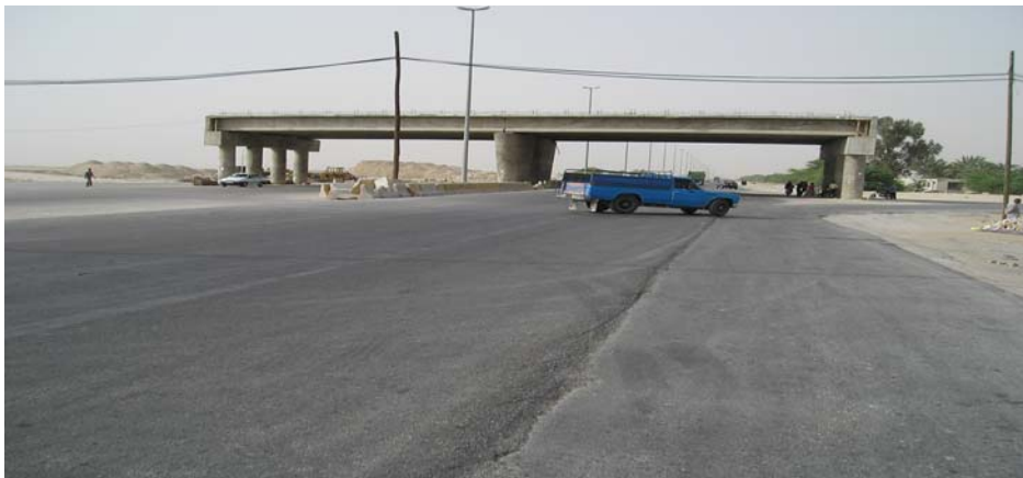
شکل ۳-۱۶: عدم وجود خط‌کشی مناسب، عدم ایمن‌سازی و حفاظت مناسب از پایه‌های پل، عدم ایمن‌سازی انتهای نیوجرسی‌ها و عدم وجود تابلوهای اطلاعاتی و انتظامی لازم در محل دورزدن از جمله مشکلات ایمنی است که در تصویر نشان داده شده مشاهده می‌شوند.
