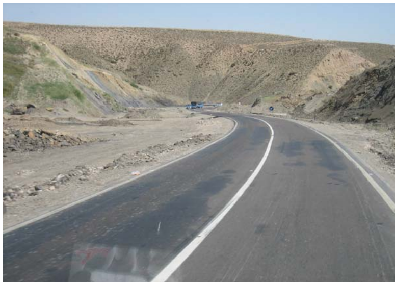
شکل ۷-۸۴: عدم نصب تابلوهای محدودیت سرعت در منطقه عملیات جاده‌ای و ورود وسایل نقلیه با سرعت معمولی به داخل منطقه
