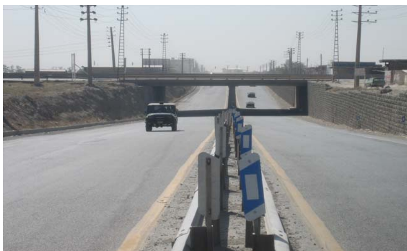
شکل ۷-۹۸: خط‌کشی نامناسب خطوط حرکت در زیر پل
