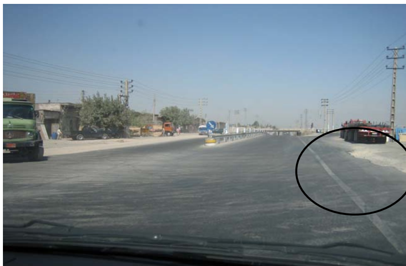
شکل ۷-۹۷: افتادگی شدید شانه در محل رمپ خروجی راه اصلی به آزادراه
