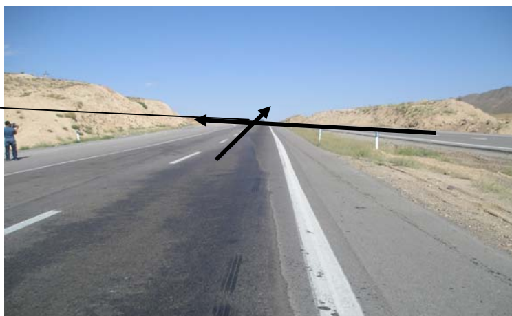
شکل ۷-۸۶: محل تلاقی راه جدید و قدیم بدون آشکارسازی لازم و مسدود کردن قسمت در حال ساخت که احتمال عبور وسایل نقلیه به داخل منطقه عملیاتی وجود دارد.
