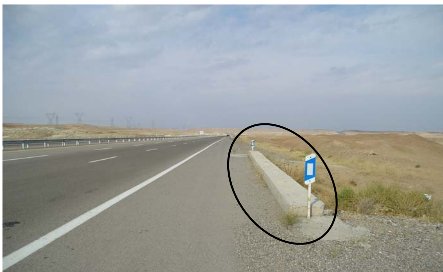
شکل ۶۸-۷: جانپناه پل که آشکارسازی شده ولی محافظت نشده است در صورت برخورد وسایل نقلیه منحرف شده، احتمال سقوط در داخل آبرو وجود دارد.
