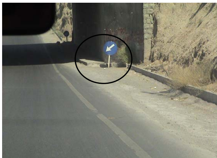
شکل ۷-۱۰۸: جدول مخصوص حرکت عابر پیاده در زیر پل که در امتداد پل ادامه نیافته و انتهای آن نیز ایمن‌سازی نشده است. خطر برخورد وسایل نقلیه وجود دارد.
