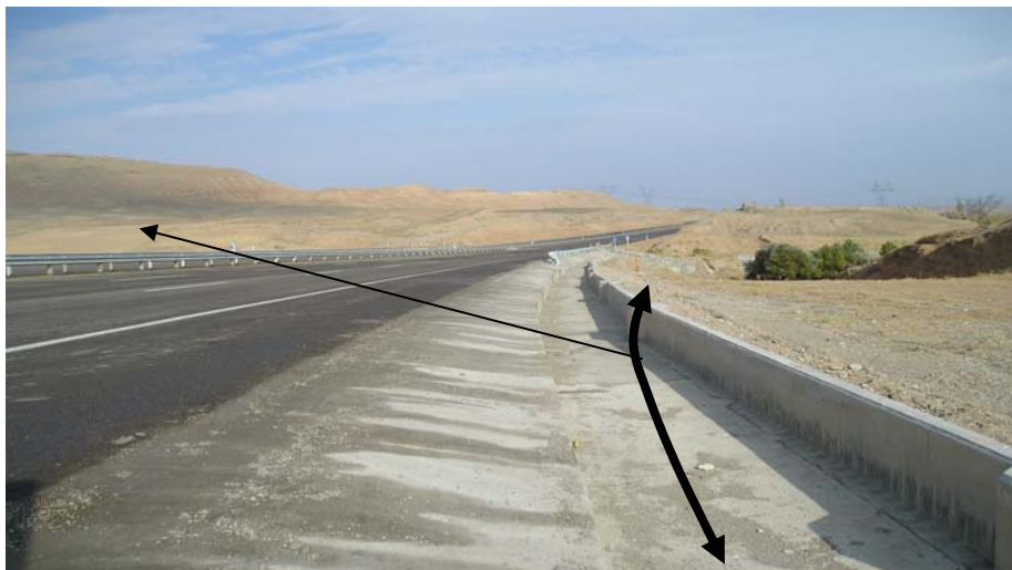
شکل ۷-۷۰: کانال احداث شده در مسیر که حفاظت نشده است و احتمال سقوط وسایل نقلیه به داخل کانال وجود دارد.
