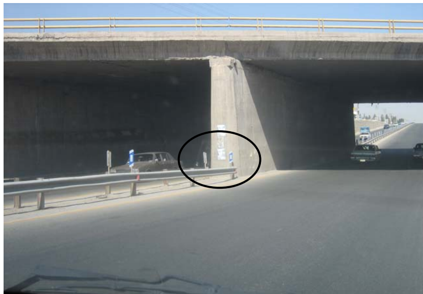
شکل ۷-۹۲: عدم وجود ایمن سازی پایه پل روگذر و اتصال نامناسب گاردریل به پایه
