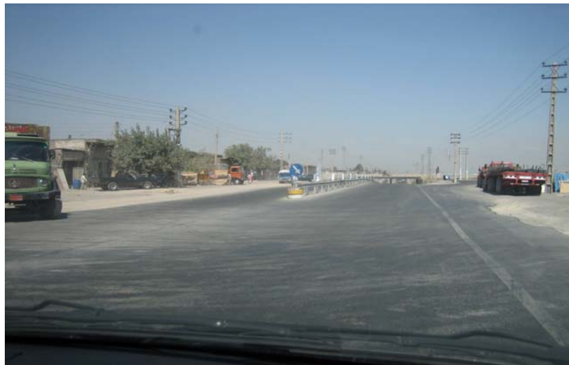
شکل ۷-۹۱: ایمن سازی نامناسب انتهای گاردریلها در محل دوربرگردان غربی
