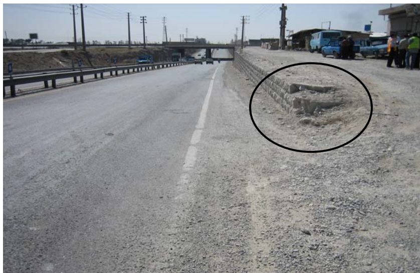
شکل ۷-۹۵: عدم ایمن سازی انتهای دیوار حایل در محل عبور غیرمجاز وسایل نقلیه که در صورت برخورد وسایل نقلیه خطر ساز است.
