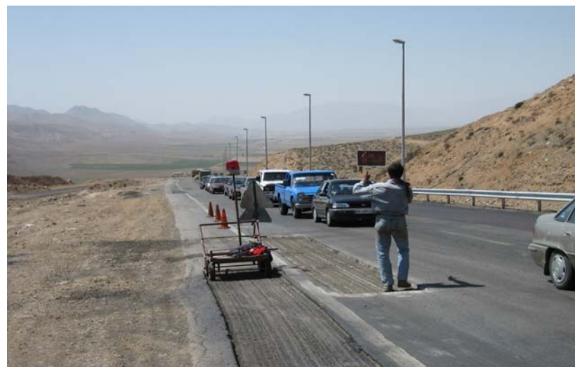
شکل ۷-۷۷: عدم استفاده از تابلوهای هشدار دهنده لازم در منطقه عملیاتی و عدم اطلاع رانندگان از محل انجام عملیات، حرکت با سرعت عادی و به خطر افتادن جان کارگران
