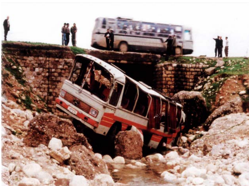
شکل ۲-۱۸: سقوط یک اتوبوس به داخل آبرو به دلیل عدم نصب حفاظ بازرسی ایمنی = پیشگیری از وقوع تصادف
