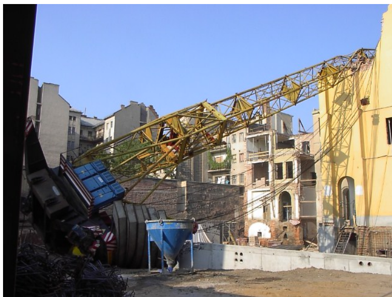
شکل ۳-۶- واژگونی برج بالابر بر روی ساختمان
