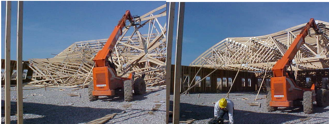
شکل ۱-۵-الف- سقف قبل از نصب.....ب- ریزش سقف
