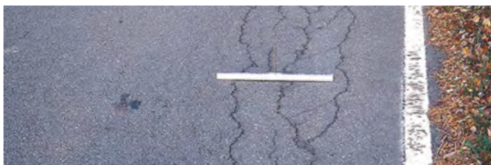
شکل ۳۷- ترک پوست سوسماری در سطح آسفالت
