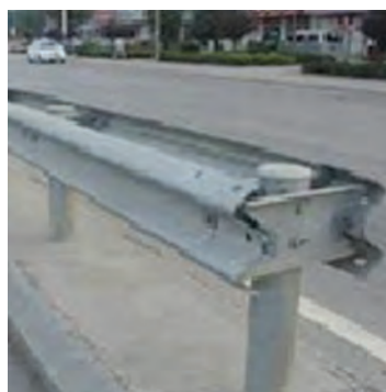
شکل ۱۰- فاصله انداز دوطرفه اجرا شده (ضربه گیر)
