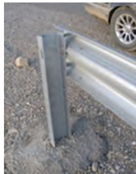
شکل ۶۳- اجرای پایه حفاظ به روش ناصحیح
