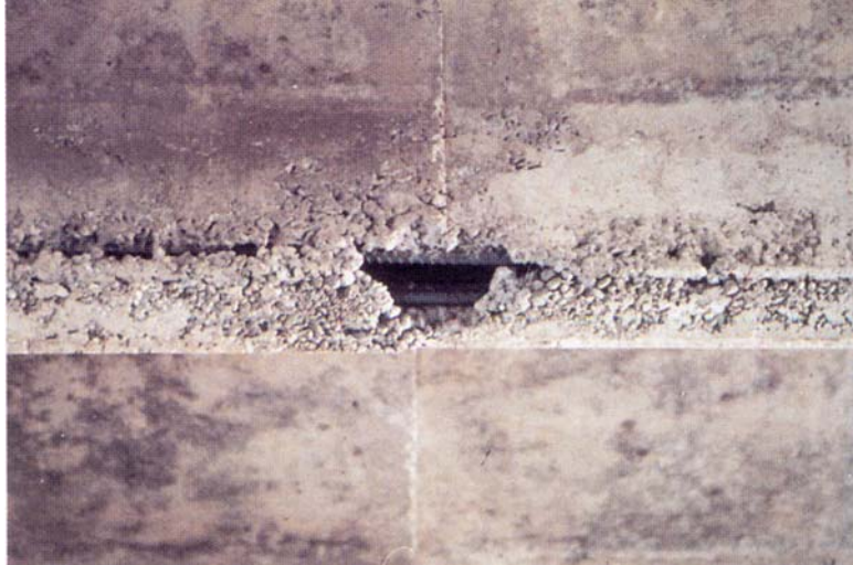
شکل ۸ نمونه‌ای از نحوه نامناسب تراکم بتن
